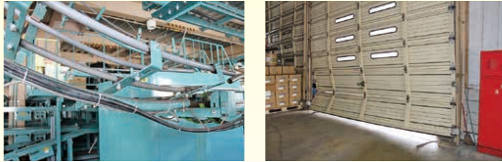
地震により被害を受けた箇所（園芸センター）※修理を行っています。
